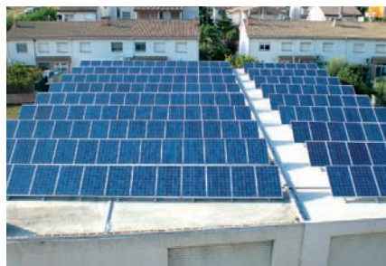
La planta fotovoltaica del carrer Eugeni d'Ors.
